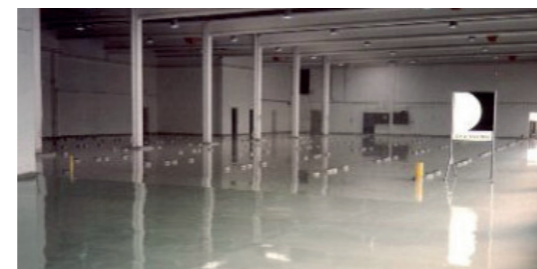
Sekundäre Barriere mittels WHG-konformer Beschichtung
