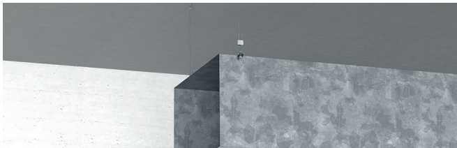
Lüftungskanal (mit Luftkanalwinkel)
